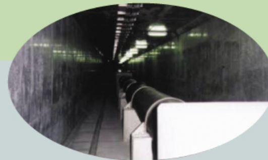
共同溝佈設之耐震管路
