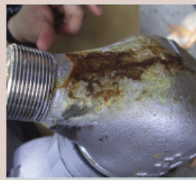
(c) 管線腐蝕嚴重
