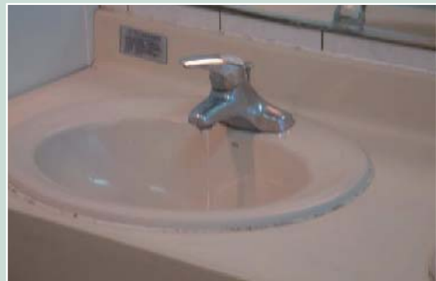
圖10 布魯樂谷園區內水龍頭流量情形
