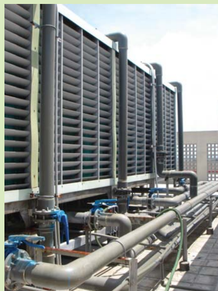
高雄大學冷卻水塔
