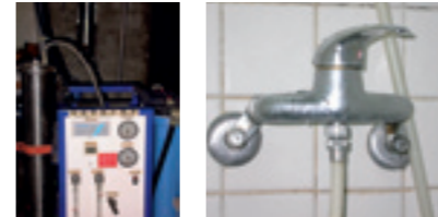
RO濃縮水回收再利用 淋浴龍頭於蓮蓬頭處增設省水器
