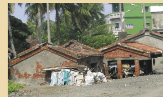
圖4 台灣南部潮州鄉地層嚴重下陷的情形
