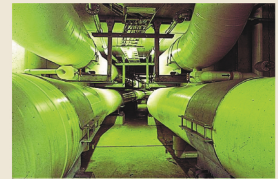
圖10 日本某社區地下共同管溝中的中水系統
