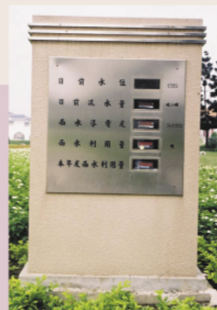
雨水貯留利用監控系統
