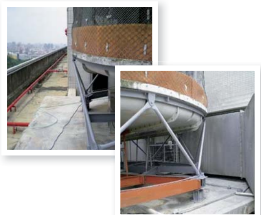
護網裝設後地面乾燥人員行走安全、節省水資源
