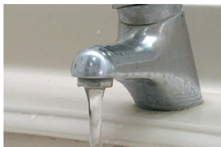
2. 調小出水量後之水龍頭出水情形
