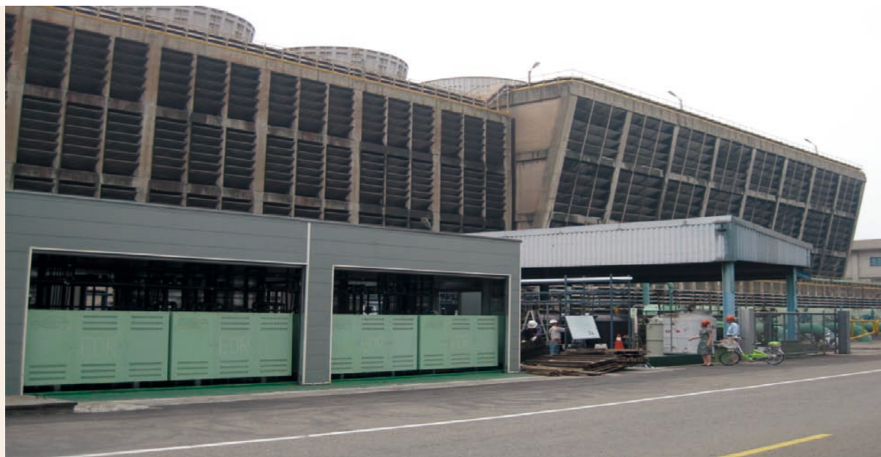
第二熱軋水場直接水系統排放水EDR回收設備
