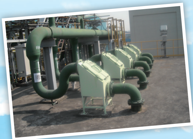
廠房屋頂雨水簡易過濾器及 TW 蓄水池
