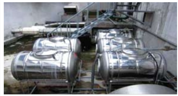
圖三 空調冷卻水回收儲存桶
