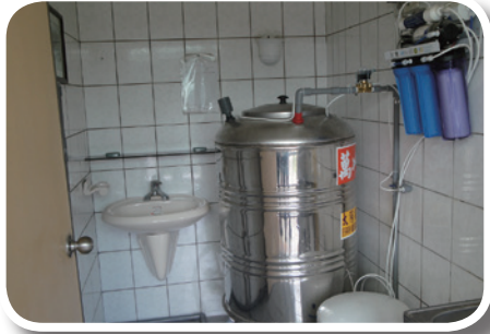
圖 9. RO 逆滲透加裝回收水再利用系統
