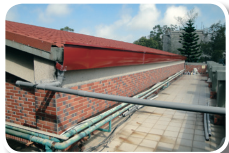
圖 8. 屋頂設置雨水回收系統
