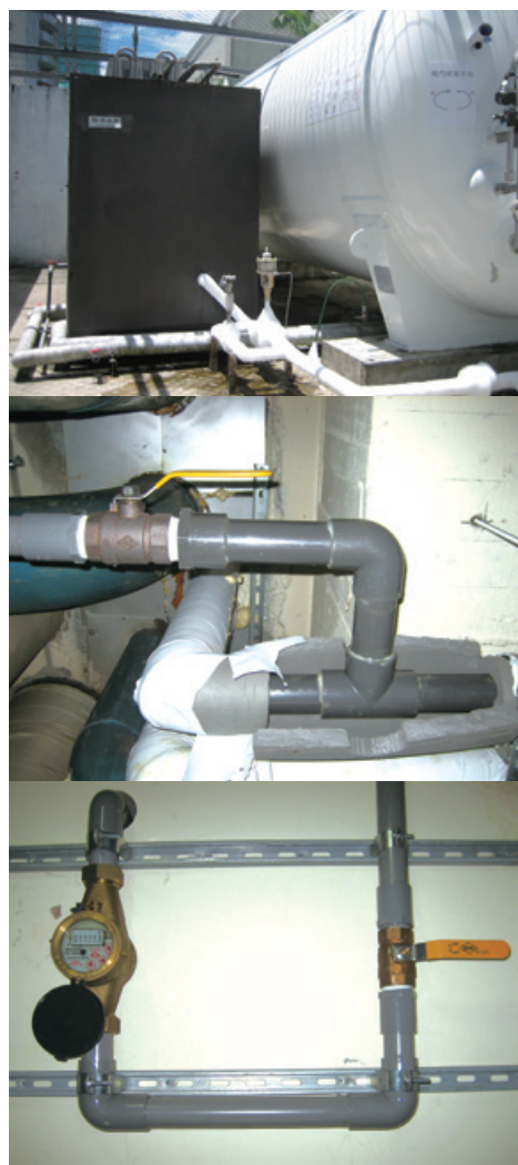
液氧槽蒸發器冷凝水回收
