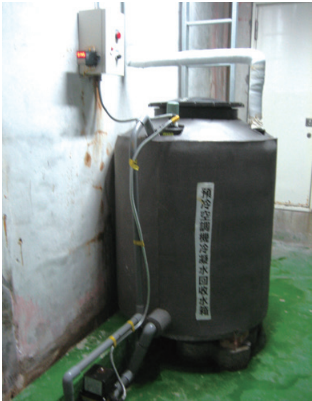
空調冷凝水回收
